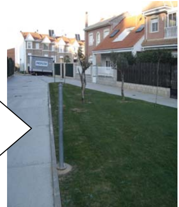
Farola que se retiró por rotura y que no se ha repuesto. Jardín de arriba.
