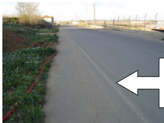
Zona de acceso a Bella Vista que carece de acera y farolas.
